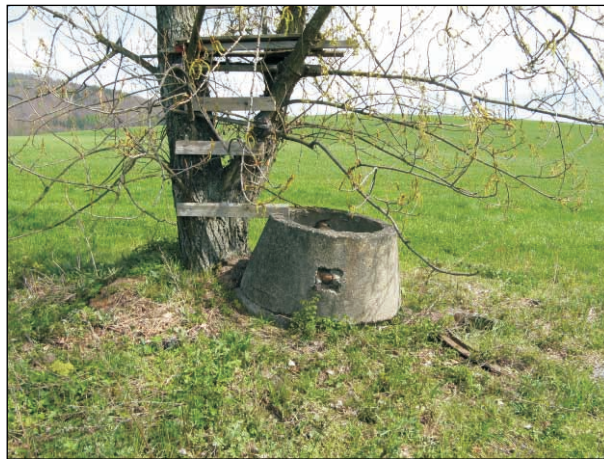
Šachta drenážního potrubí v JZ části skládky - odběr vody PV6-3
